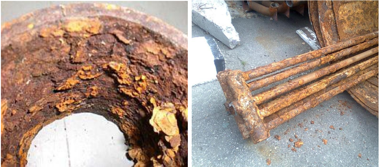
Рис. 1.1. Наслідки впливу корозійних процесів на металеві конструкції
